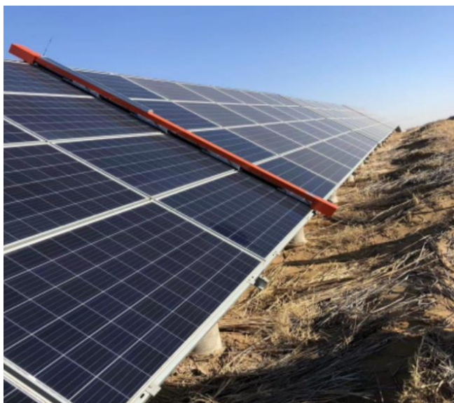
图 2.15 光伏清洁机器人实际安装展示图
