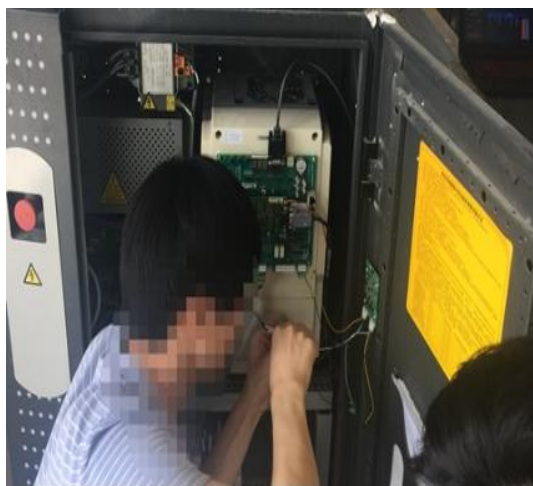
图 2.5 网关现场安装图
