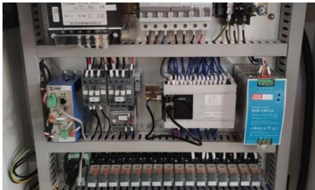
图 2.16 锯床 PLC 控制箱
