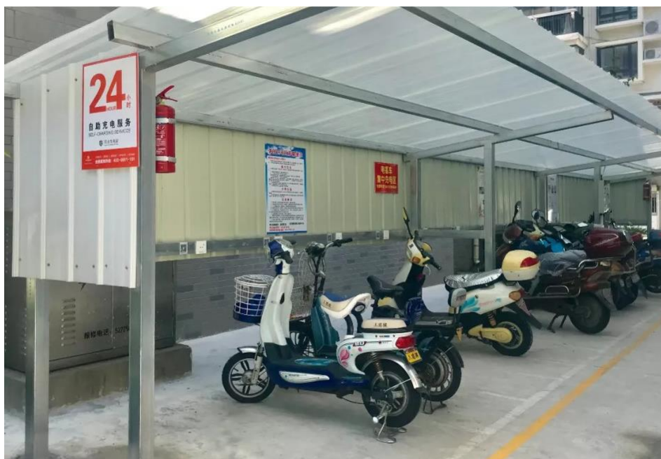
图2.33 充电桩实际安装场景
