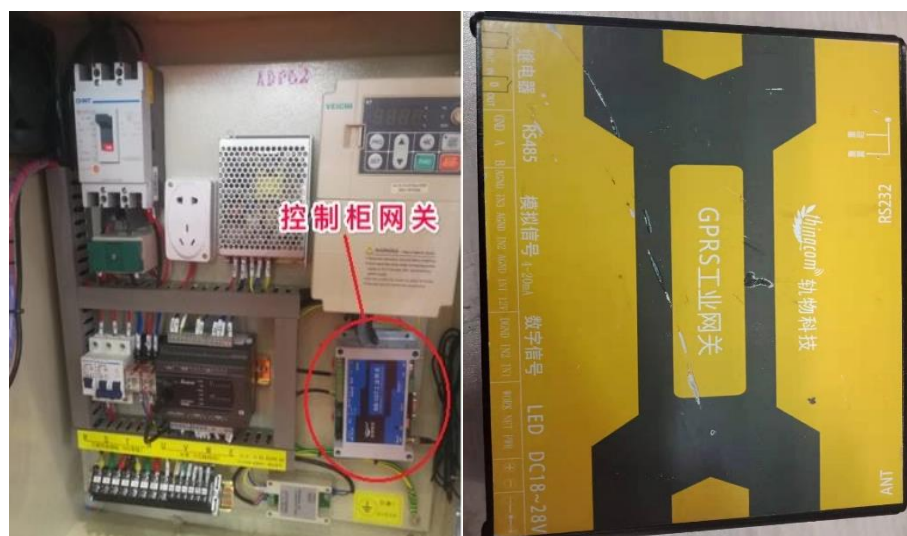
图 2.24 控制柜连接图及数据采集网关
